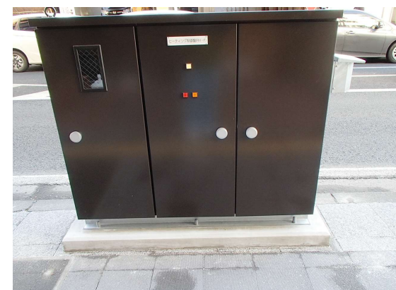
盛岡停車場線4.ヒーター制御装置.JPG
